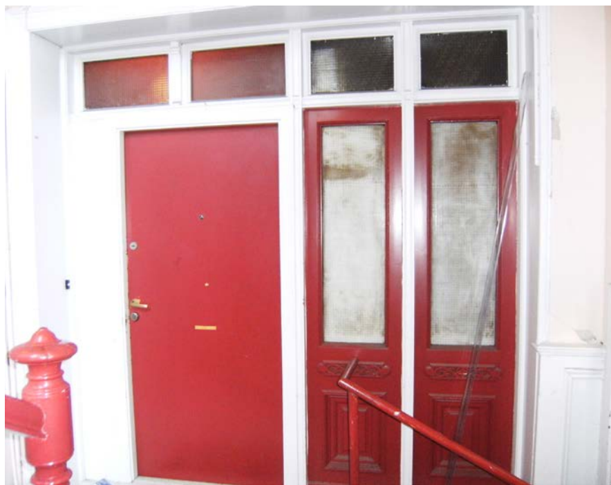
Mange trapperom har blitt ødelagt fordi originale dører har blitt skiftet ut.
