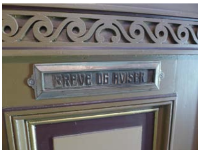
Eldre brevsprekker kan enkelt bevares og brannsikres ved å felle inn et massivt trestykke som tilpasses spalten.
